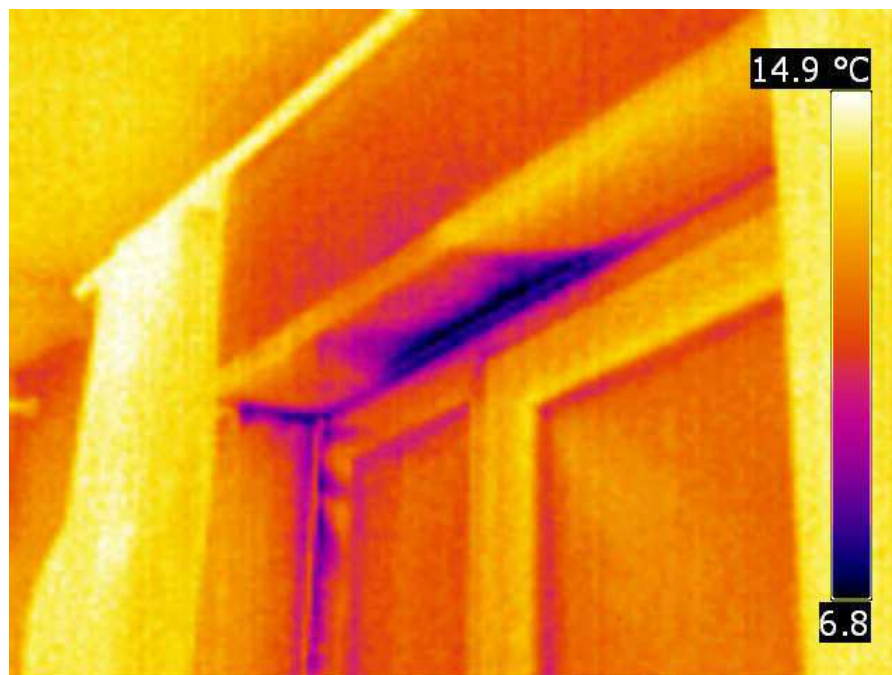
Raccord fenêtre / mur extérieur non étanche
