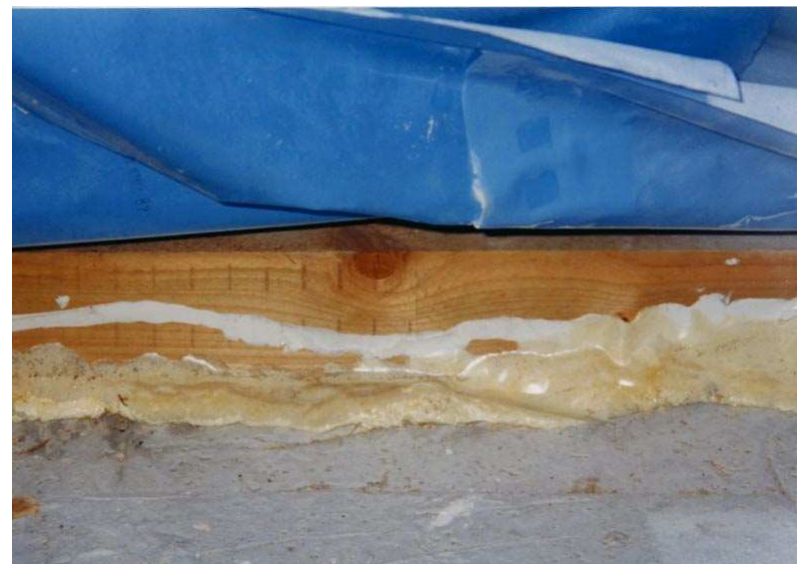
Utilisation de colles non adéquates
