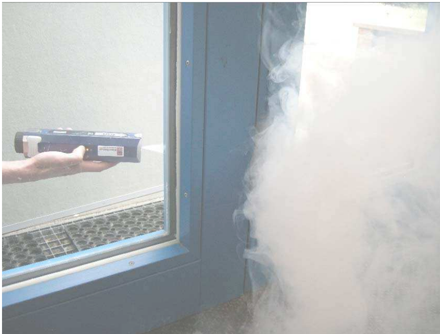
Porte d'une maison passive non étanche
