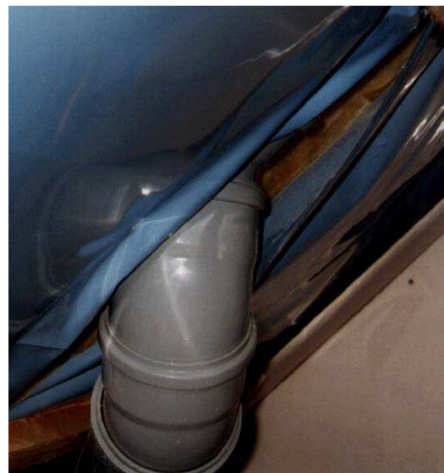
Passage de conduits non étanche
